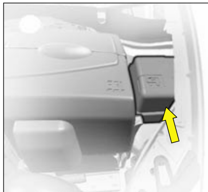
Fusibles sous capot moteur
